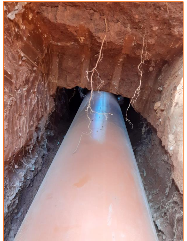
Foto 8. Instal·lació del tub de serveis per la part interior del mur de finca de l'hospital per tal d'evitar-ne el contacte.
