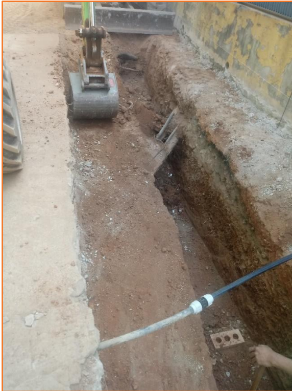
Foto 3. Obertura de la rasa de manera esglaonada i descobrint els diferents serveis
